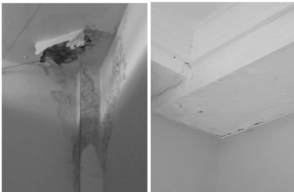
Figura 1.1 Exemplos de anomalias (infiltrações e vazamentos).
