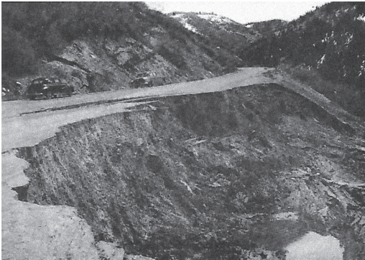
Figura 2.1 – Erosão possivelmente causada por águas de chuva.
