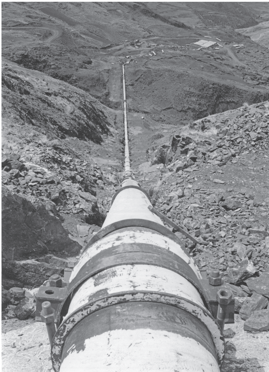
Sifão invertido na adutora Hampaturi (barragem-captção, NA 4.203 m.s.n.m.) a Pampahasi (ETA, NA chegada 3.840 m.s.n.m.), que abastece La Paz (Bolívia) por gravidade. Tubulação em FFD, JE, PN 40, DN 800, 13,8 km, implantada em 1991 a 1992. (No ponto mais baixo passa na cota 3.632 m, após uma quebra de pressão). Projeto MFyF.
