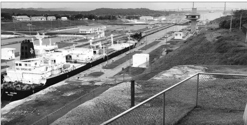
Figura 24.127 Eclusas de Água Clara: finalização da abertura de porta a jusante da câmara superior.
