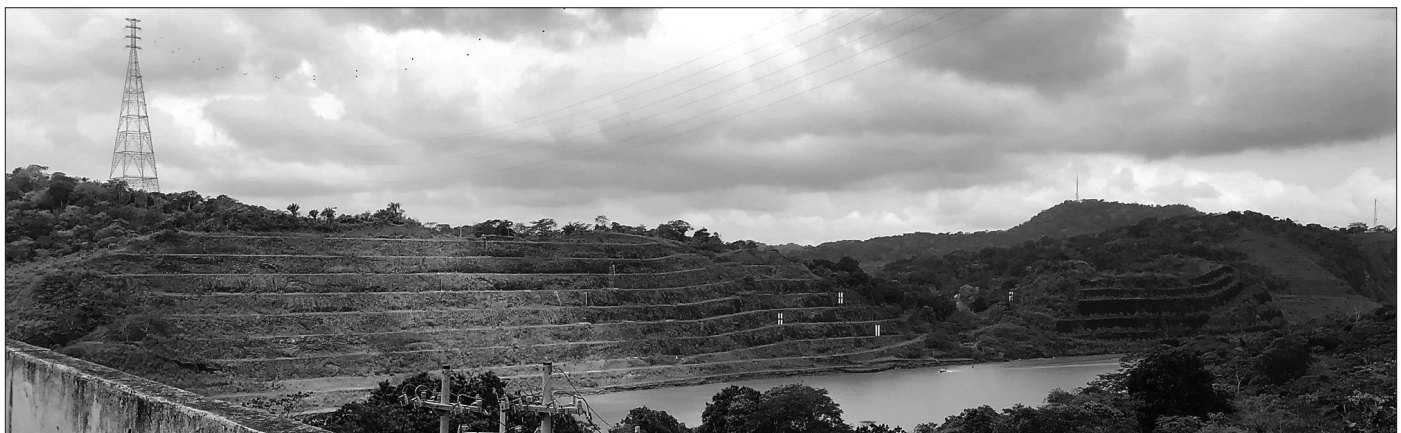
Figura 24.74 Aspectos do talude norte do Corte Culebra observados a partir da ponte Centenária.
