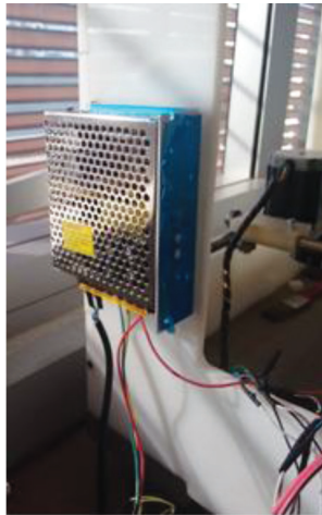
Figura 8 Detalhe de fixação da fonte 12V CC do lado de fora da máquina.
